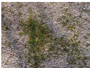
surface avec mauvaises herbes
